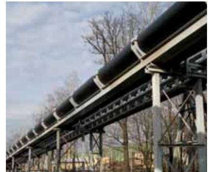
KGHM Польша Медж АС. Трубопроводы на опорах Трубы WehoPipe d.900 мм
