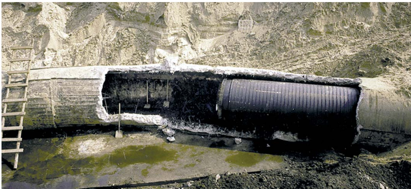
Ремонт бетонной трубы (внутренний d=1800 мм) с помощью полиэтиленовой трубы СПИРО (внутренний d=1500 мм).
