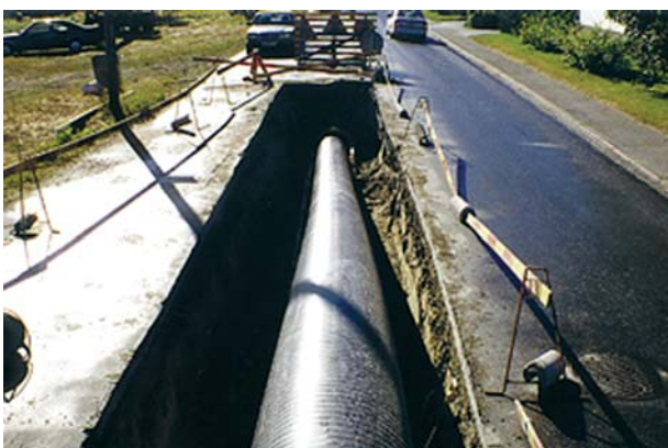
Трубы на строительной площадке. Земляные работы сведены до минимума, что позволяет не нарушать график движения.
